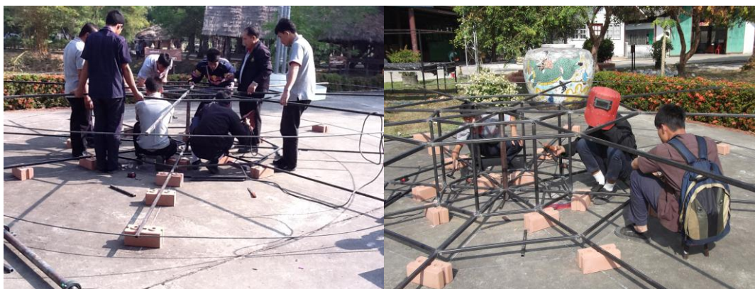
รูปที่ 18 แล้วนำโครงด้านในมาเชื่อมเข้ากัน
