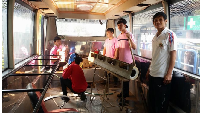
รูปภาพที่ 33 ทำโครงโต๊ะและเชื่อมให้ติดกับผนัง
