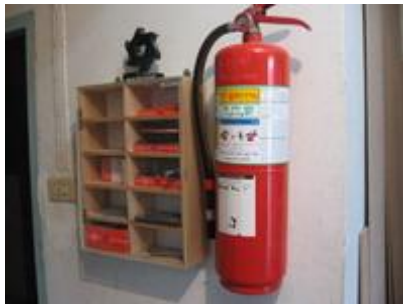
ภาพที่ 18 เครื่องดับเพลิง
